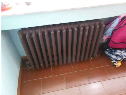
Figura 4.8 – Particolare radiatori in ghisa e acciaio
