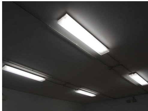
Figura 8.10 - Particolare di una plafoniera a tubi fluorescenti
