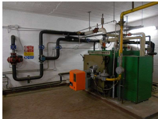
Figura 4.13 - Particolare della centrale termica
