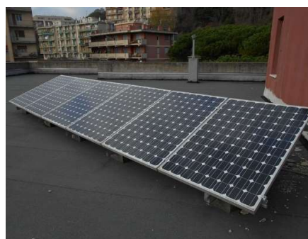
Figura 4.18 - Vista dell'impianto fotovoltaico
