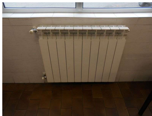
Figura 4.9 - Particolare dei radiatori in alluminio
