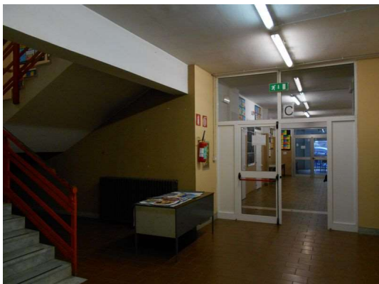
Figura 4.16 - Particolare dei corpi illuminanti ubicati in un corridoio
